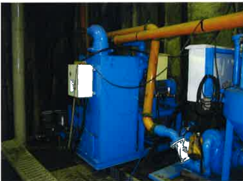
真空ユニット
