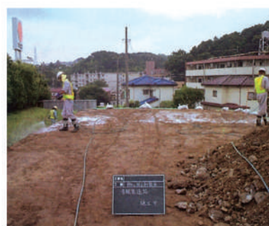
未舗装道路（非走行面）
