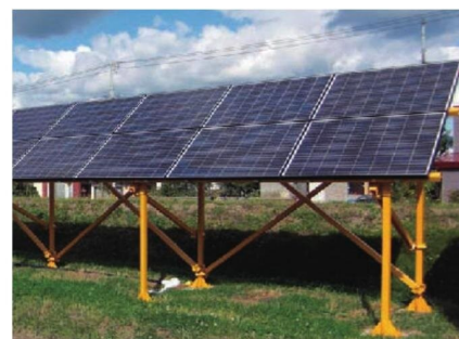
太陽光発電の架台
