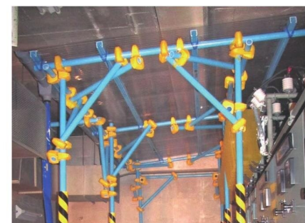
電気室内の仮設として
