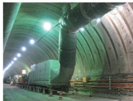
集塵機に接続
